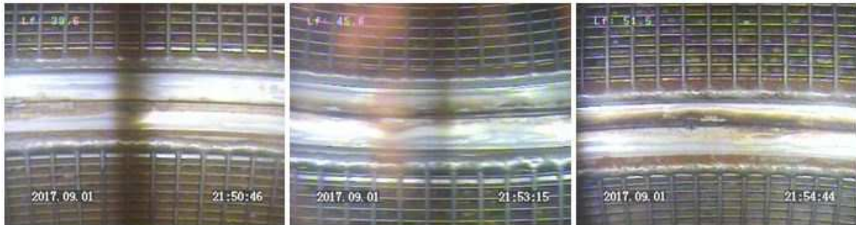
Figure 4 : Joints visibles dans les crépines
