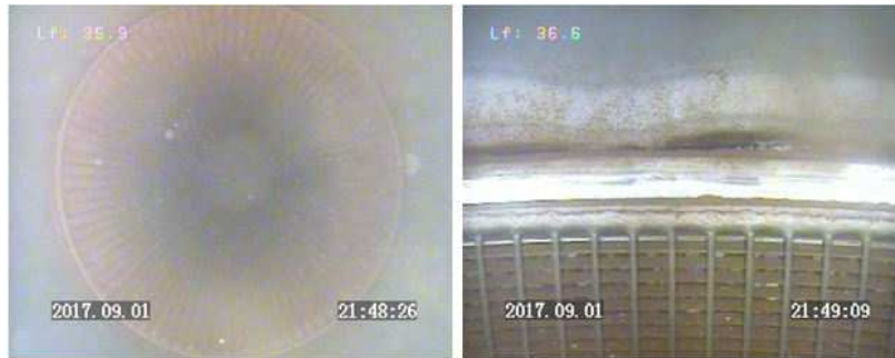
Figure 3 : Entrée dans les crépines
